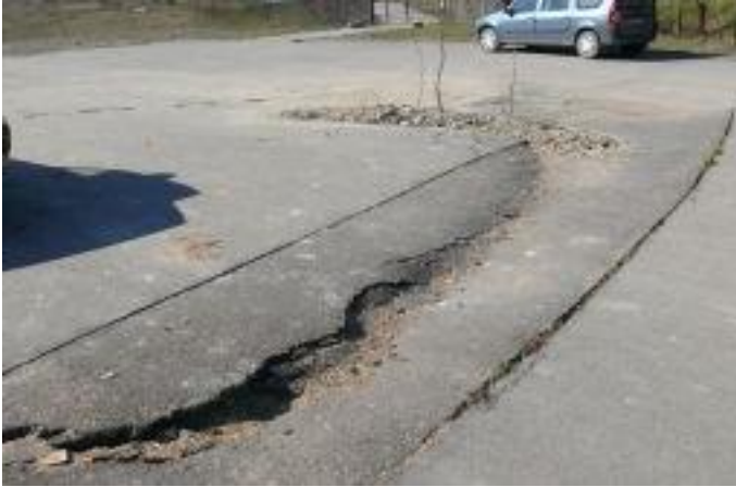
7. Fisuri și rupturi ale drumului de legătură cu orașul în zona marginală a albiei de scufundare, în 2015.
